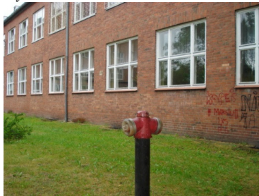
Hydrant nadz. Na terenie ZSM-I
